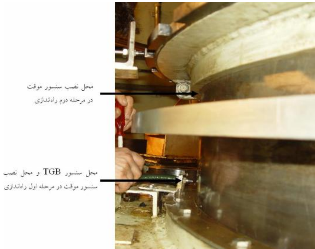
شکل ۱: محل نصب سنسور IN-085 در دو مرحله راه‌اندازی و محل سنسور TGB
